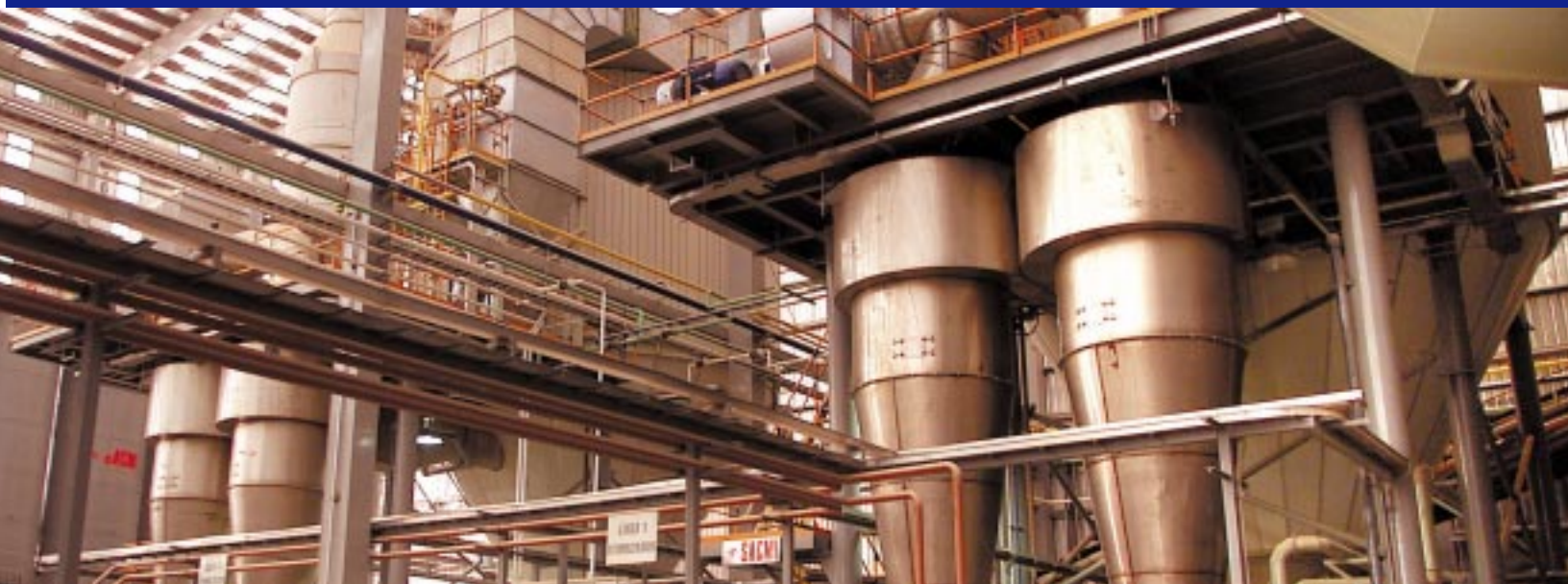
San Jos Iturbide, Gto. con capacidad de 7 millones m 2 /a-o.
