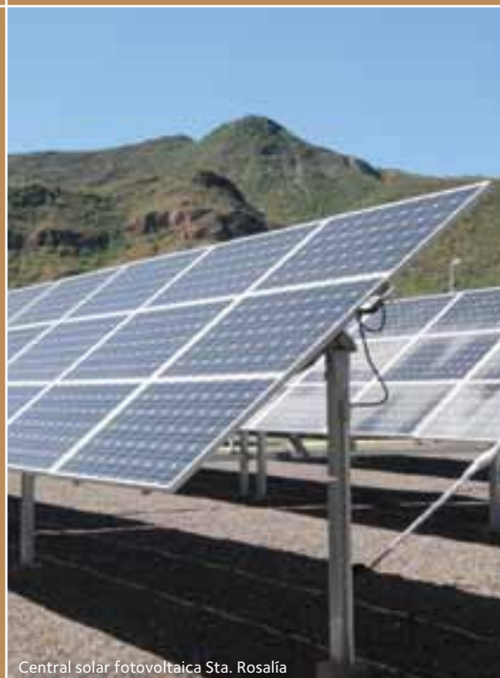
Central solar fotovoltaica Sta. Rosalía
