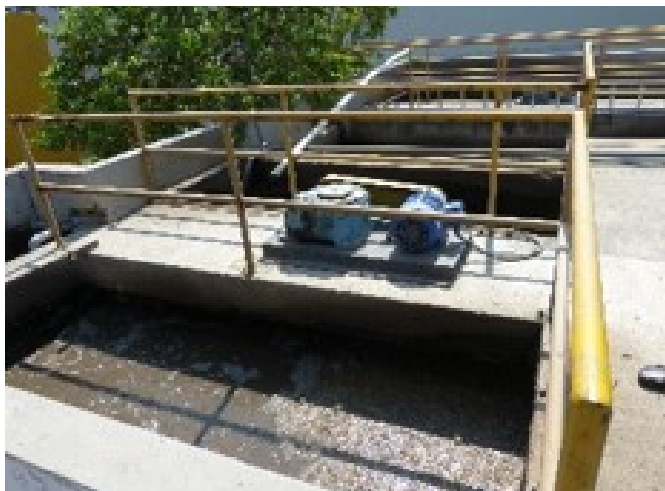
Planta de tratamiento Conducel
