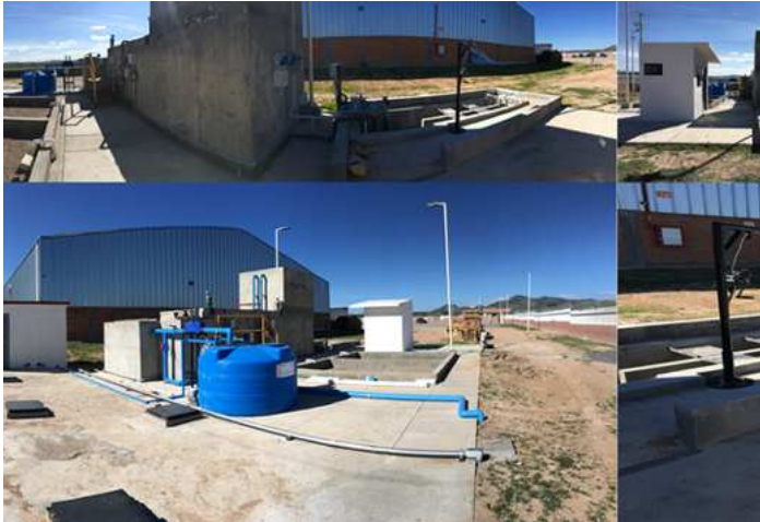
Habilitamiento y preparación para la puesta en marcha de la Planta de tratamiento de agua sanitaria en Arela San Diego de la Unión.
